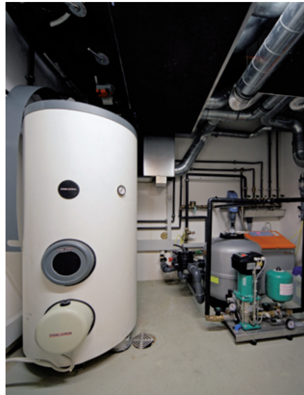
Die Haustechnik sorgt für Wärme und Frischluft.
